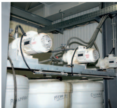
Синтетические емкости для хранения добавок загружаются от уровня \pm 0 . Все загрузочные трубопроводы централизованно объединены.
