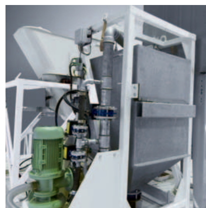
Весы для воды с откачивающим насосом для подачи воды под давлением в смеситель.
